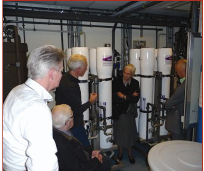
Medewerker dialysetechnici geeft uitleg over de werking van de waterinstallatie
